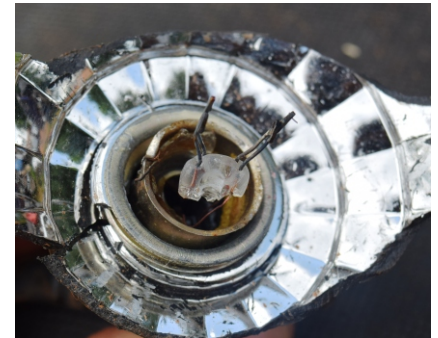
Figura N°6: Focos rotos en frío, sin oxidación de forma inmediata.
